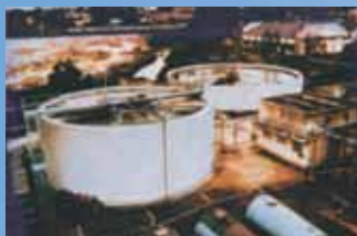
Contact stabilisation unit
